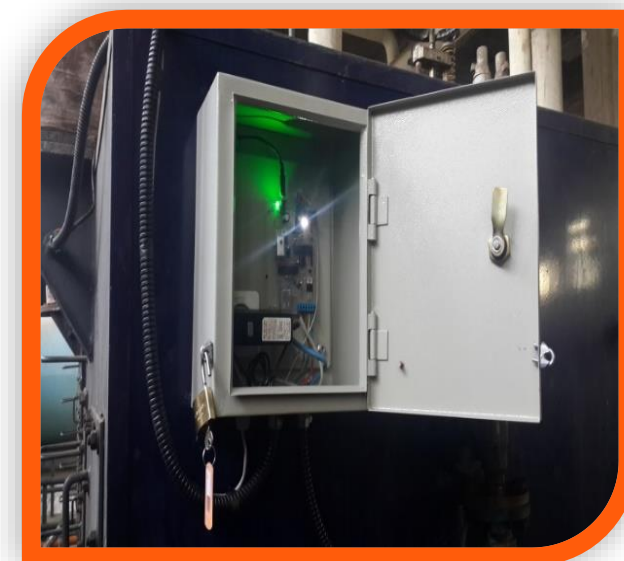
تابلو کنترلر سوخت / اکسیژن و دمای دیگ بخار آب
